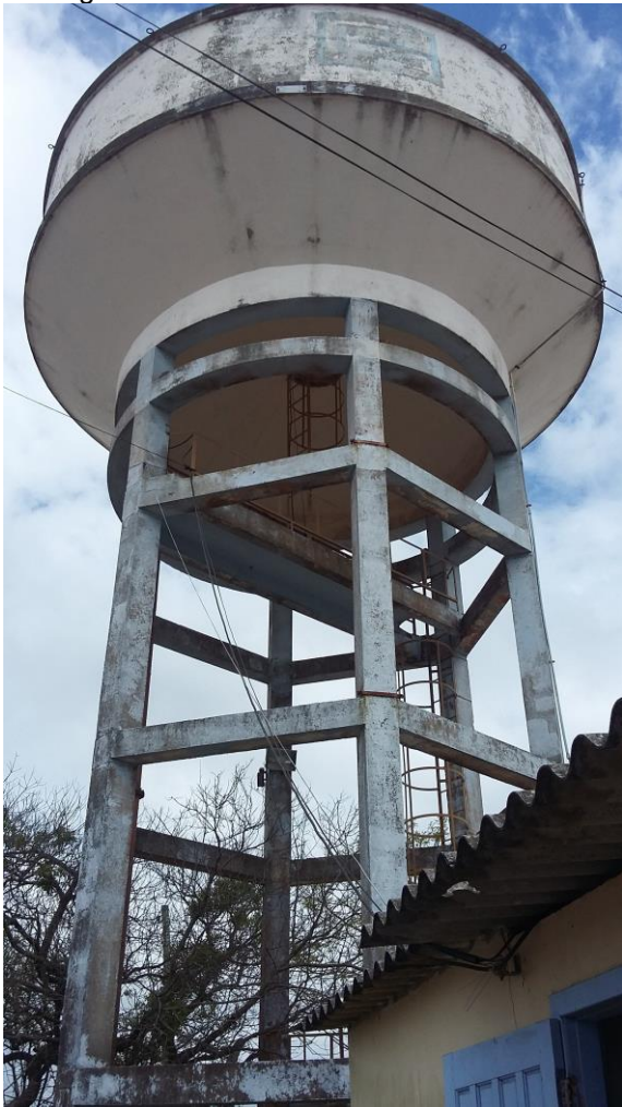
Figura 4-12 - Reservatório R1 - 100 m 3
