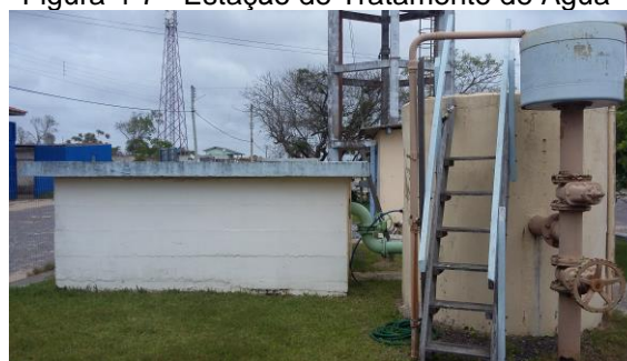
Figura 4-7 - Estação de Tratamento de Água
