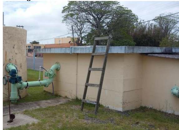
Figura 4-13 - Reservatório R2 - 14 m 3
