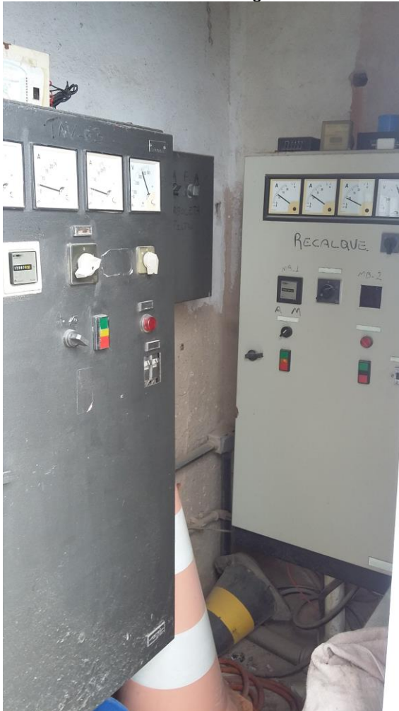
Figura 4-9 - Quadro elétrico da Estação de Tratamento de Água
