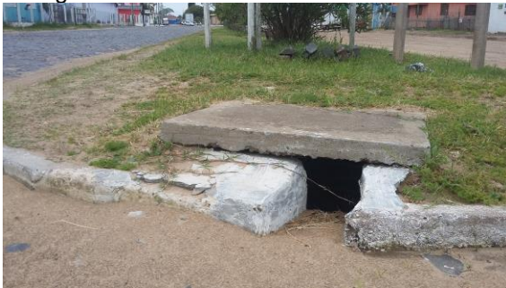
Figura 7-4 – Bueiro na Av. Onze de Abril
