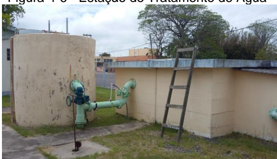
Figura 4-6 - Estação de Tratamento de Água
