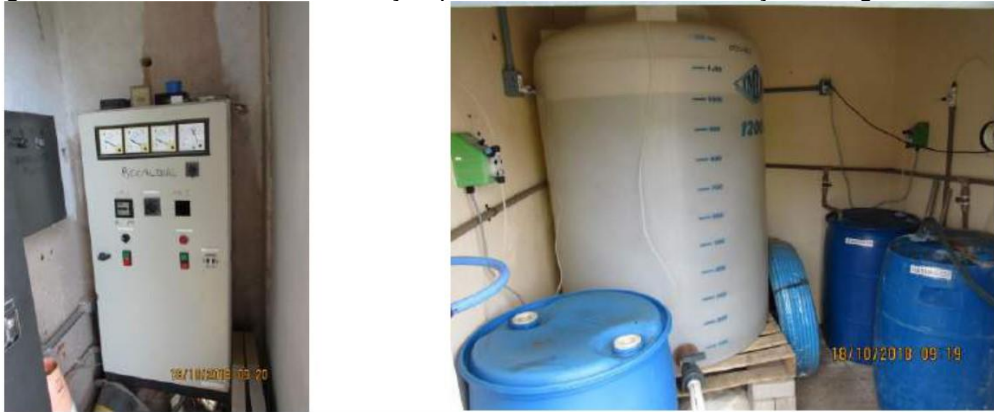
Figura 4-8 - Quadro elétrico e solução para tratamento e desinfecção da água
